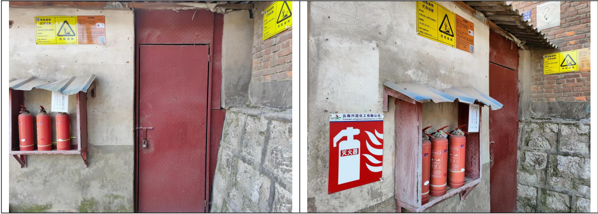
图 7.2-33 现有危废暂存间
