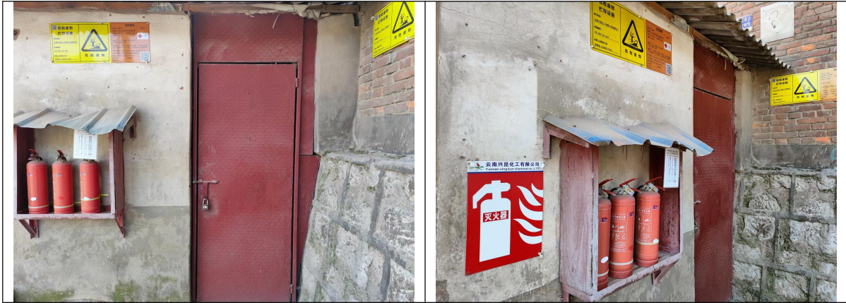
图 7.2-33 现有危废暂存间
